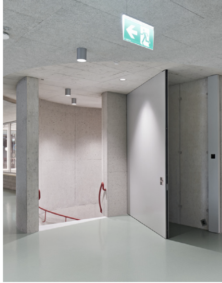
Schliessung aktiviert sich im Brandfall.
